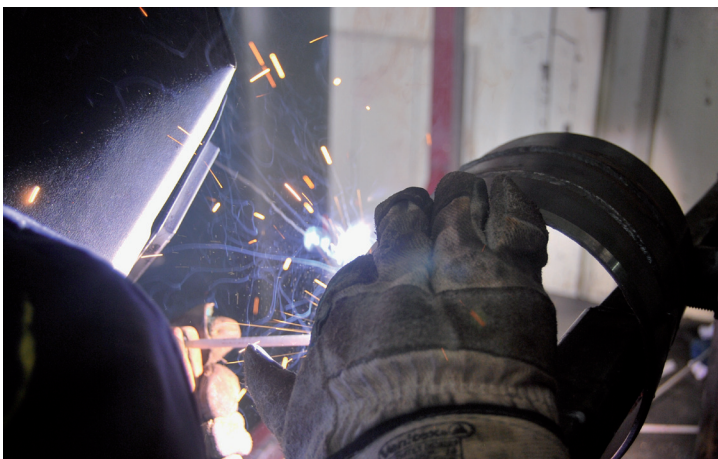
Soldadura de tubería de acero al carbono con electrodo en posición 5G
